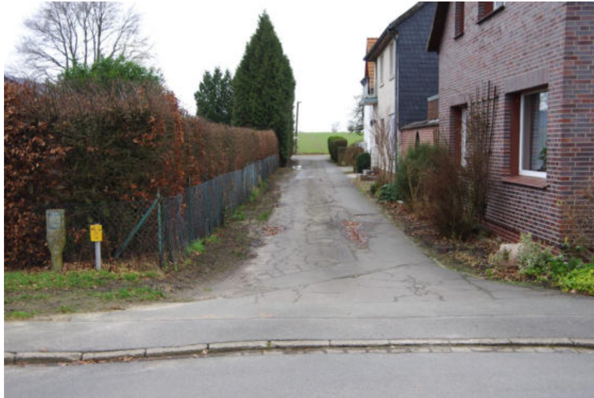
Altendorf Nr. 8: Erneuerung vom Mittelweg (3 m breite Asphaltfahrbahn zeigt altersbedingte Schäden)
