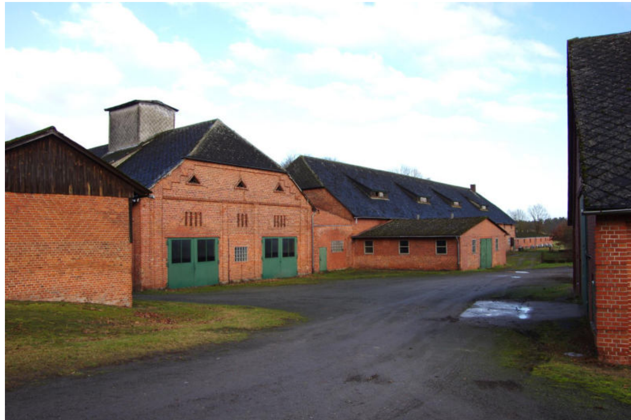
Leerstehende bzw. untergenutzte Altgebäude – mit ihrem Verlust droht im Ortskern (Boitzenhagen) ein Verfall
